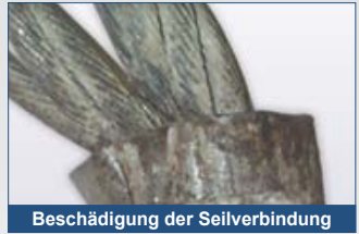
Beschädigung der Seilverbindung
