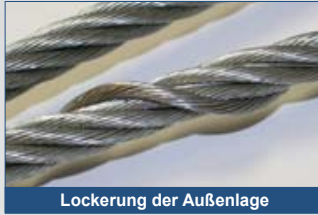
Lockerung der Außenlage
